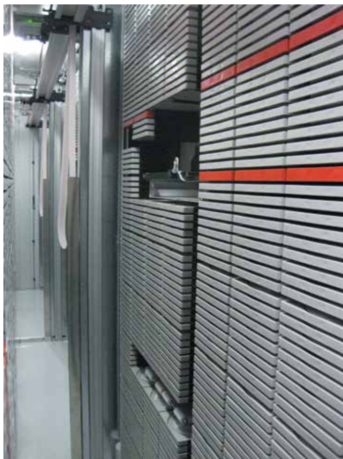
5 Система ACS 2000: внутри, расположение лотков
